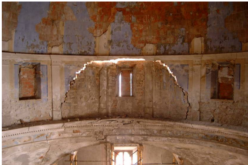
Fig.7 Vista de la grieta del tambor desde el interior en febrero de 2001 al comenzar las obras
