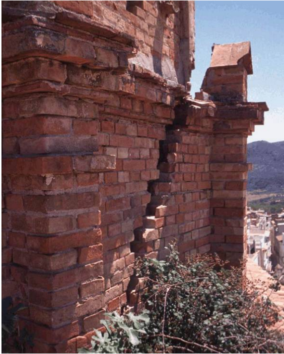
Fig.5 Grieta en el tambor desde el exterior
