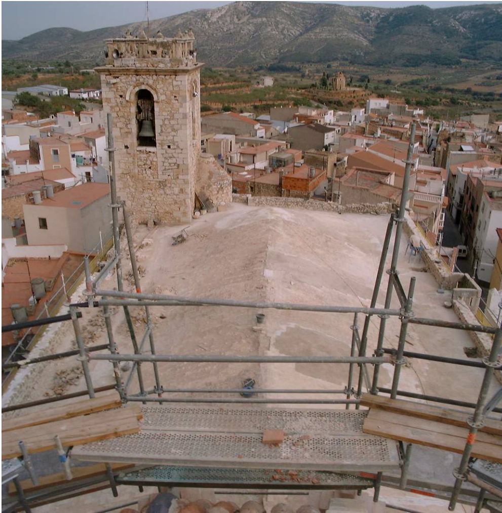
Fig. 14 Vista de los restos de la cubierta original sobre las naves góticas (agosto 2001)
