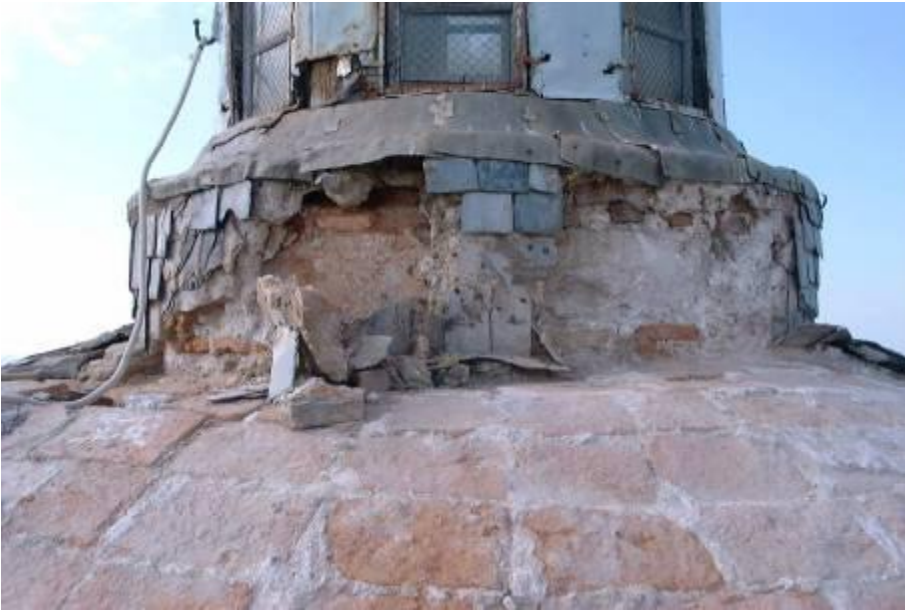
Estado del tambor del cupulín durante la restauración, al descubrir la fábrica deteriorada.
